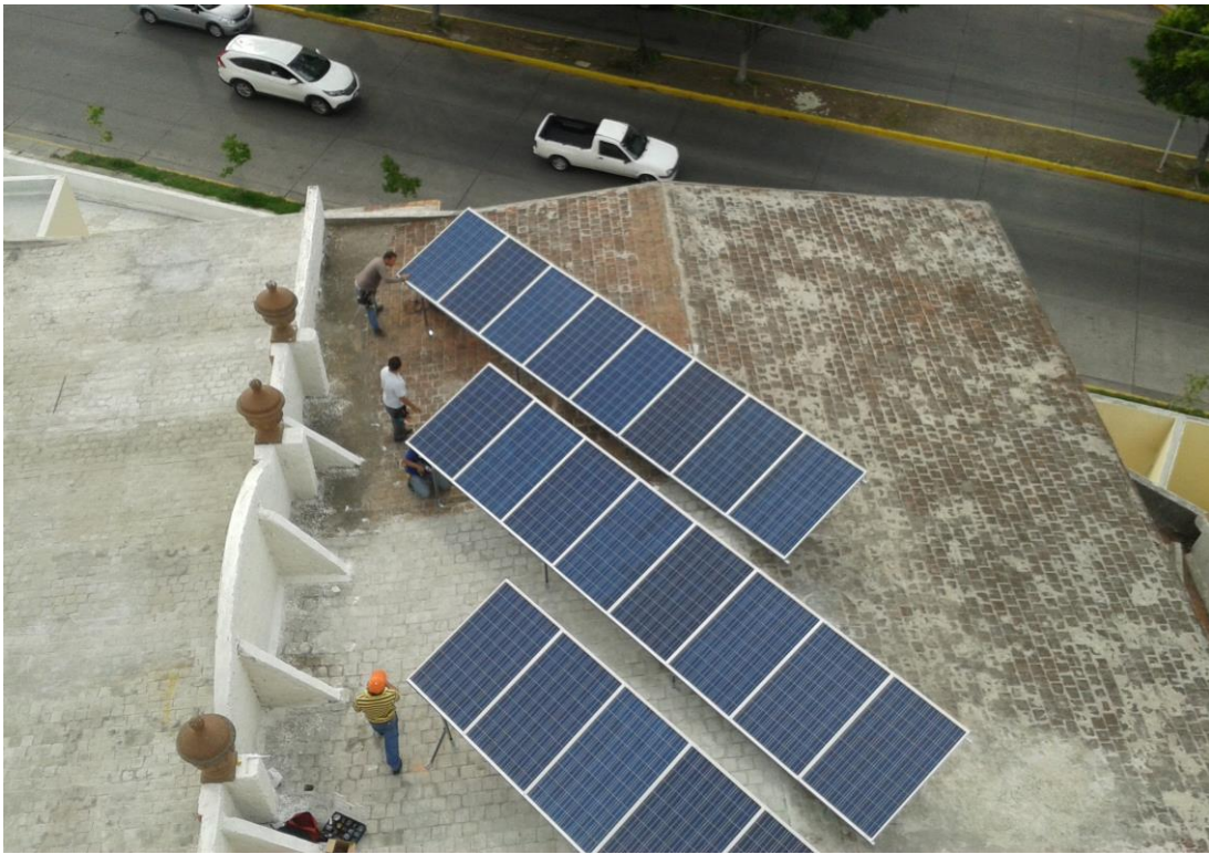
Parroquia Santa Clara Contacto: PBRO. ALFREDO M. VELAZQUEZ Instalación de 5.52 KWP
