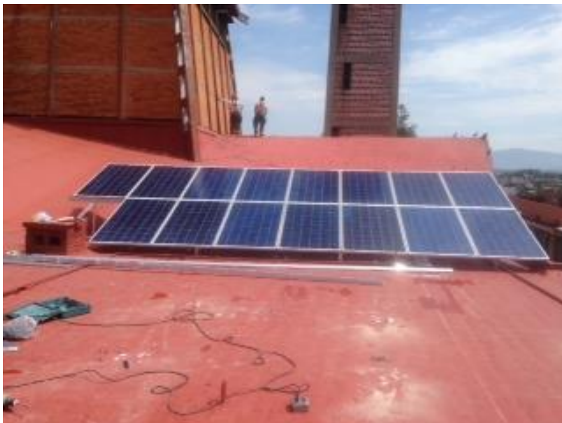
Parroquia San Alfonso María Ligorio Contacto: PBRO. RAMON GUTIERREZ FLORES Instalación De 6.125 KWP Direccion: GPE Victoria 26 A
